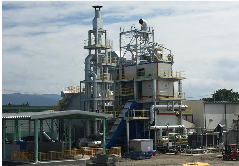
錦町2 MW木質バイオマス発電所
