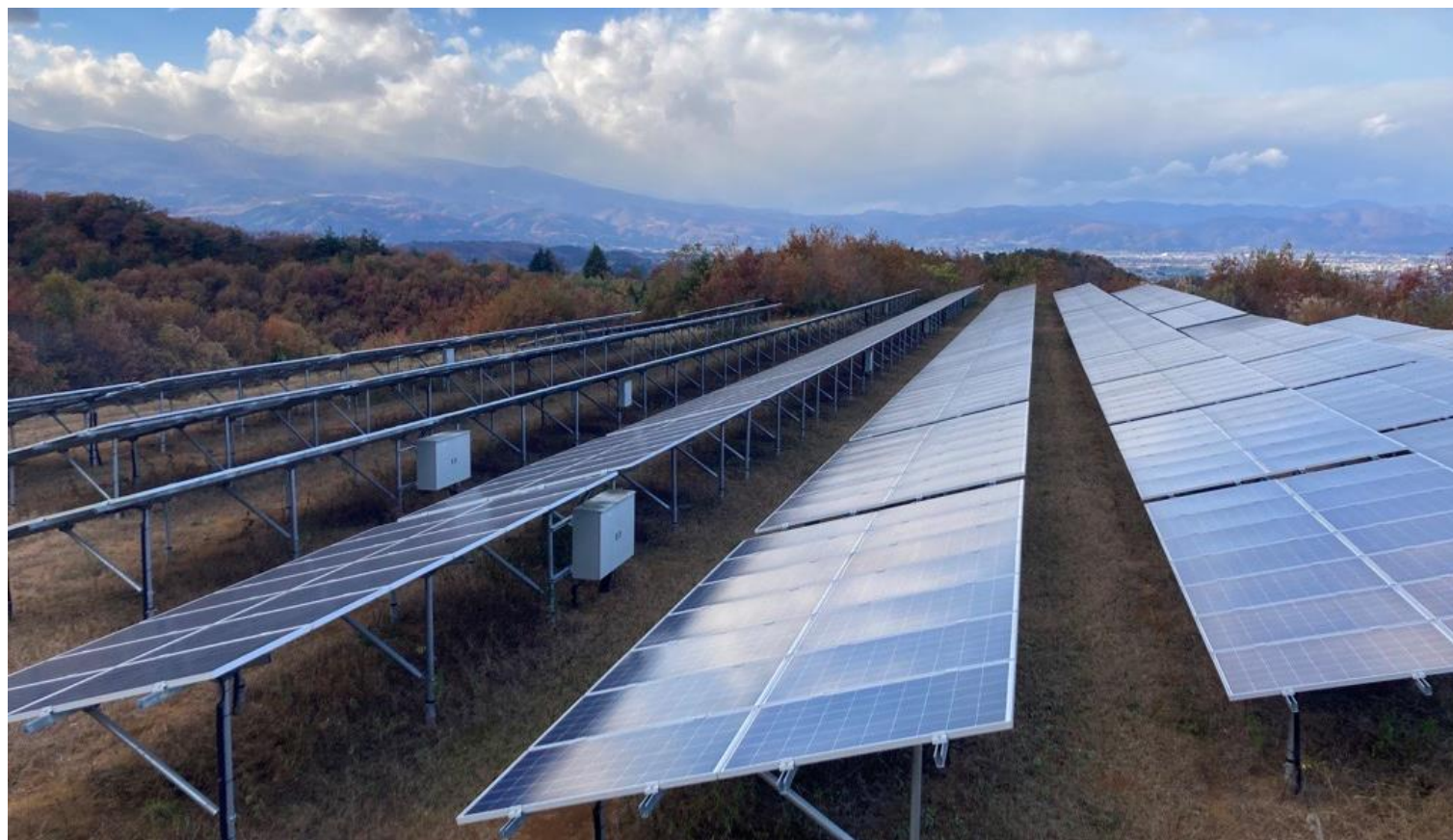
（TESS福島田沢ソーラー発電所）
