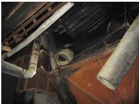
図76 エルボ一部分が外れたダクト
