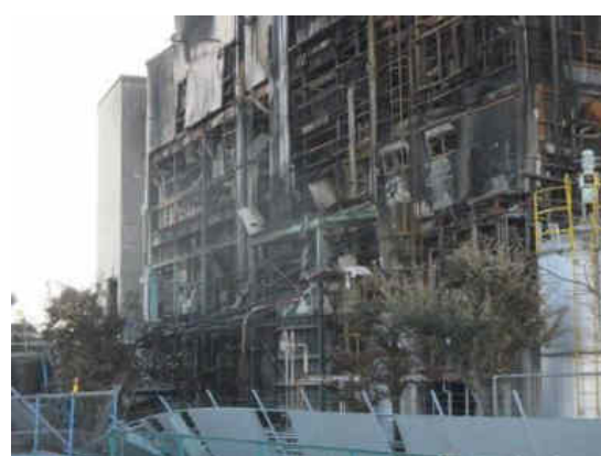
図 95 発災後の製造棟北壁
