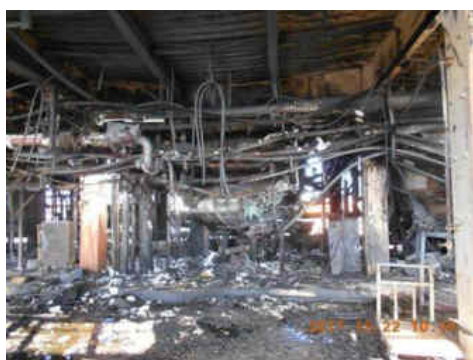
図 104 3階製造釜B付近の焼損状況
