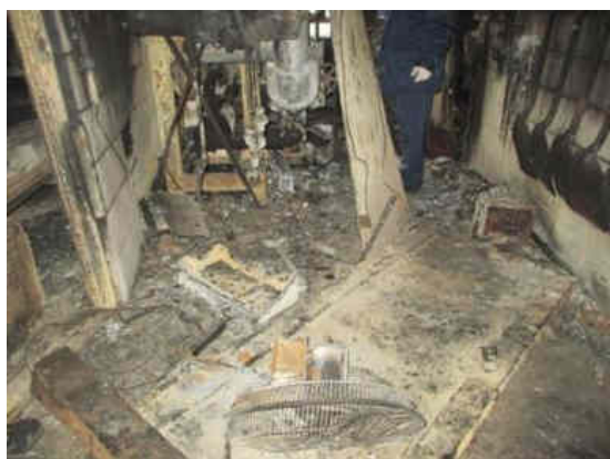
図 94 吹き飛んだ南固化室の扉
