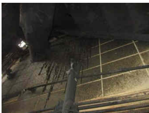
図 99 当該製造棟1階集じん機近くの北壁
