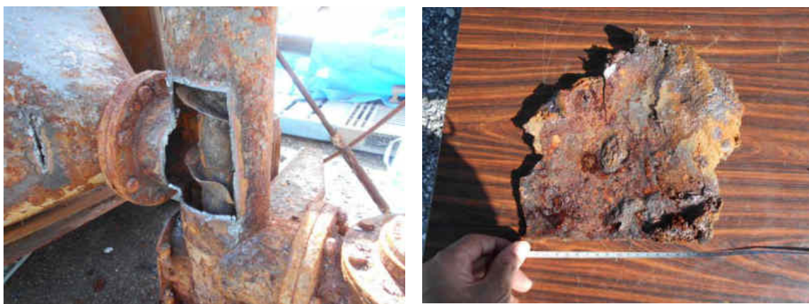
図 72 集じん機左側下部のスクリーフィーダーの羽根の変形状態と底部を塞いでいた鋼板
