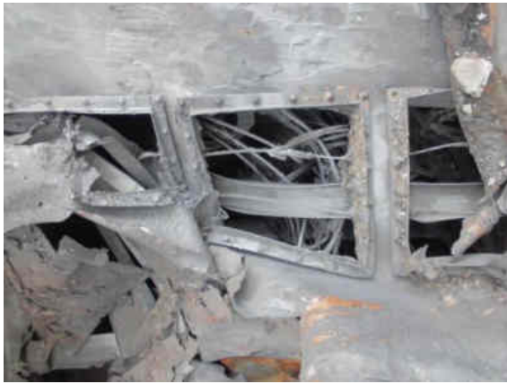
図 83 集じん機の放散口
