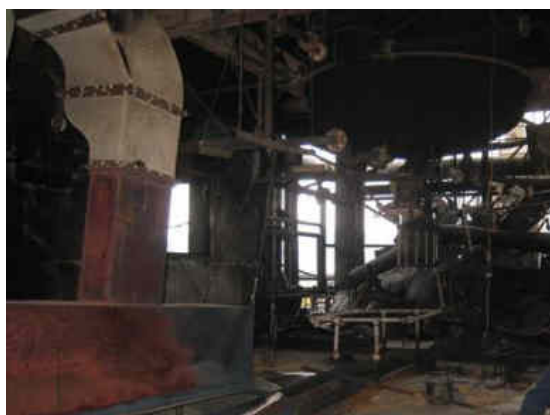
図 92 崩壊した南固化室西壁
