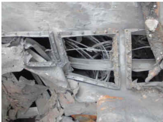
図74 集じん機の放散口
