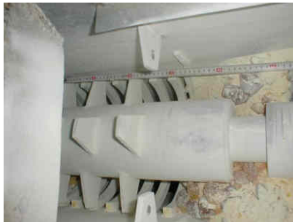
図 43 スクリューコンベア先端の解砕機（北固化室，発災前）
