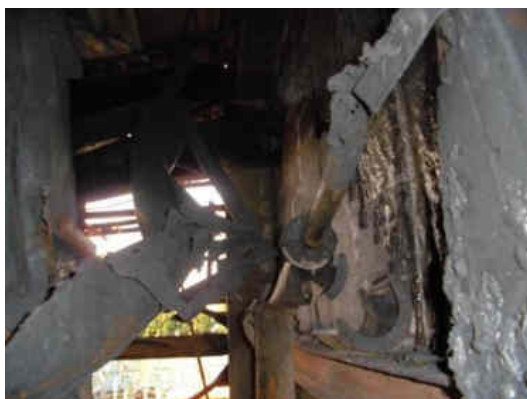
図 77 破断したキシレン溶液の配管
