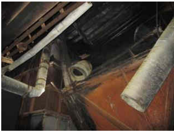
図 85 エルボ一部分が外れたダクト
