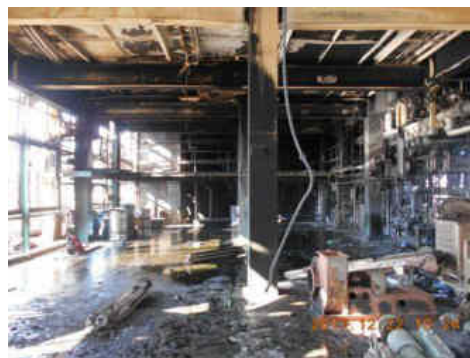
図 80 熱媒油で汚れた 2階床面
