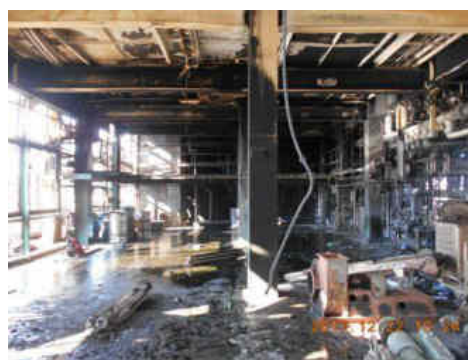
図 105 熱媒油で汚れた2階床面
