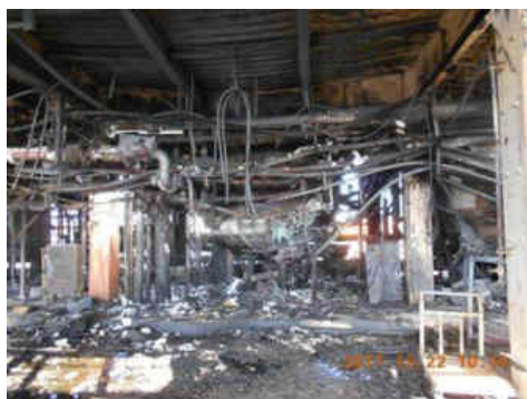
図 79 3階製造釜 B 付近の焼損状況
