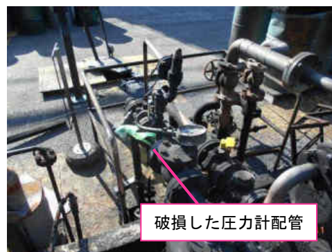
図 82 破損した圧力計配管（キシレンポンプ周辺）
