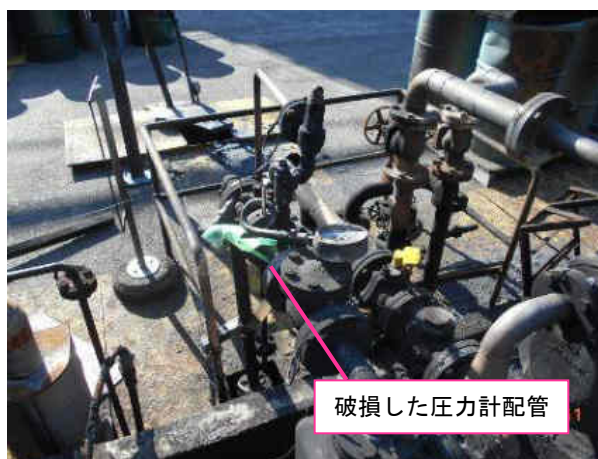
図109 破損した圧力計配管(キシレンポンプ周辺)
