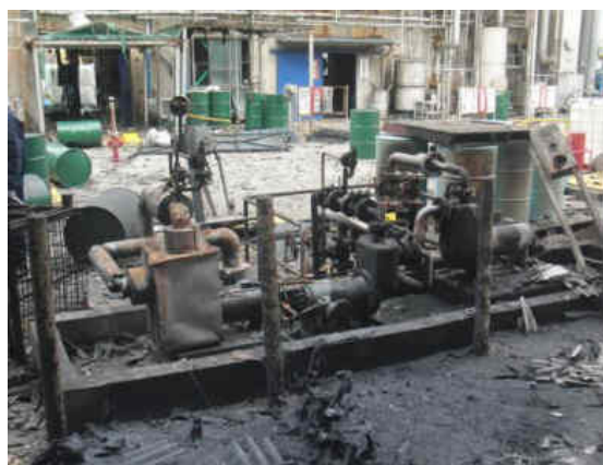
図 23 ②キシレンポンプ
