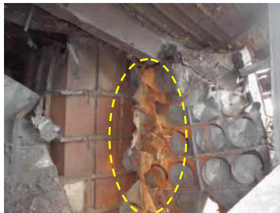
図75 角ダクトの残がい
