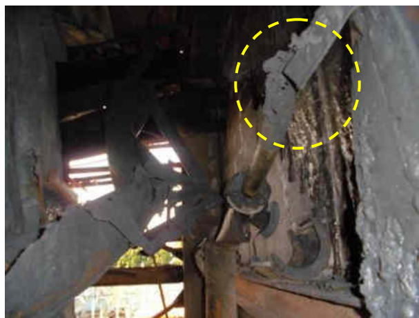
図 98 破断した配管
