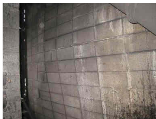
図 93 変形した南固化室の東壁
