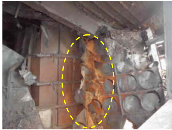
図 84 角ダクトの残がい
