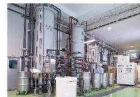
イオン交換樹脂再生設備
