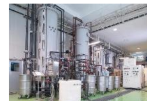
イオン交換樹脂再生設備
