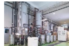
イオン交換樹脂再生設備
