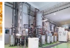
イオン交換樹脂再生設備
