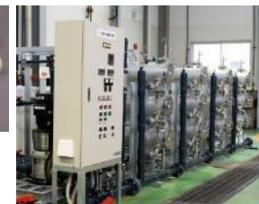
分離膜洗浄設備
