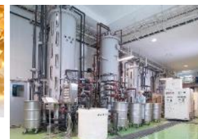
イオン交換樹脂再生設備
