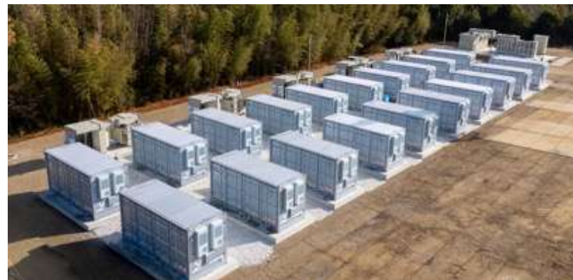
昨年導入した 特高蓄電所の例
