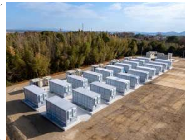
大規模蓄電所（特別高圧蓄電所）の例 (PowerX)
