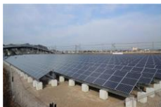
太陽光第一発電所
