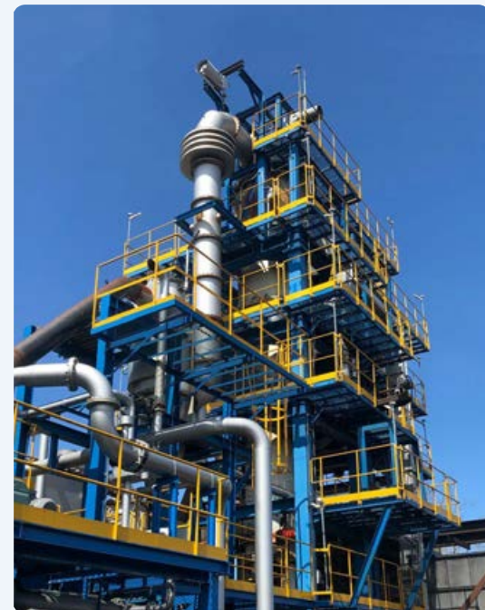
石狩バイオマス発電所
