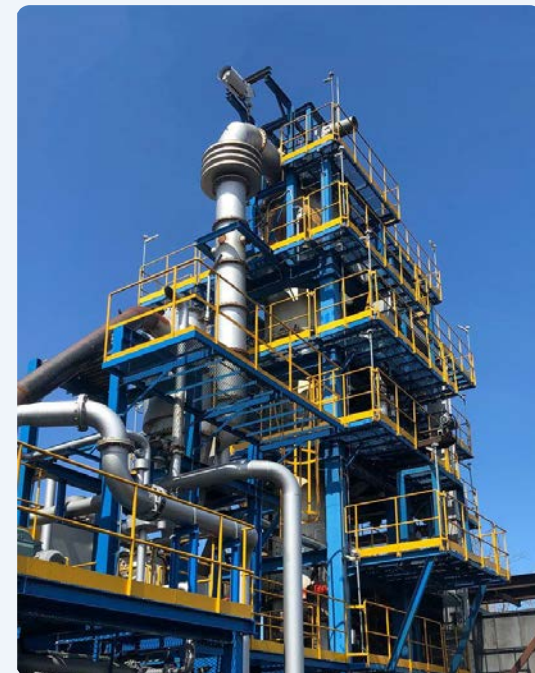
石狩バイオマス発電所
