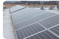
太陽光発電所
