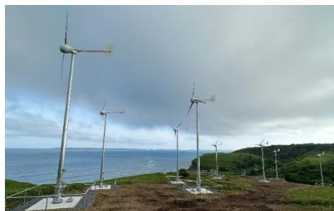
発電量5kw/基(北海道 幌戸)
