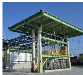
既存混合エマルジョン化設備
