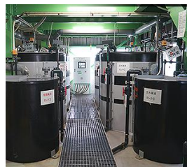
既存レアメタル回収設備
