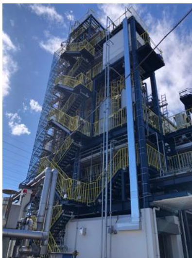
▲本社工場蒸留塔
