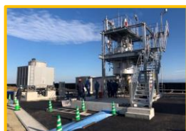
アライアンス先 蒸留再生設備
