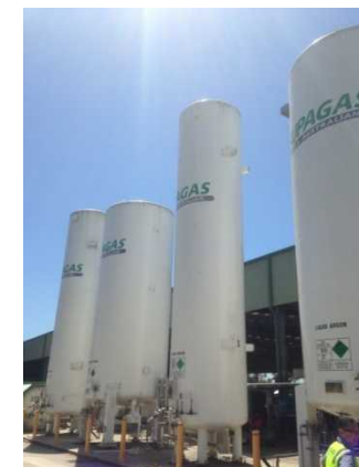
Renegade Gas社製造設備 (オーストラリア)
