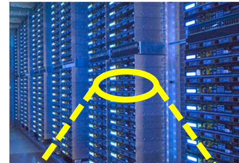
データセンター
