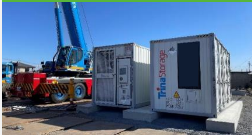
系統用蓄電池
