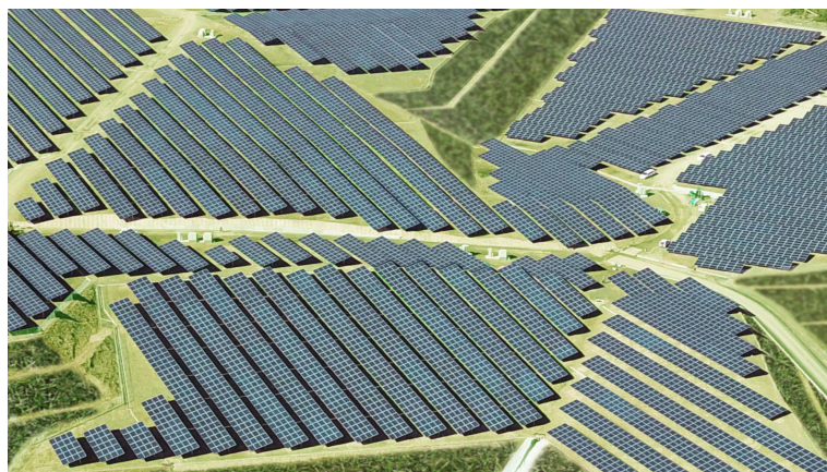
開発例: 角田市太陽光発電所 / (DC) 18.3MW
