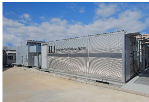
松江DCP設置のコンテナDC
