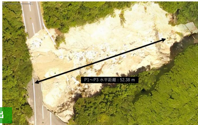
被災地の被害規模 距離確認
