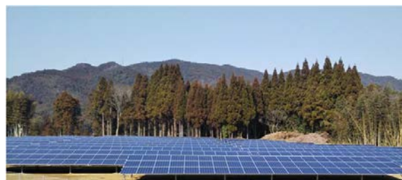
馬場太陽光発電所
