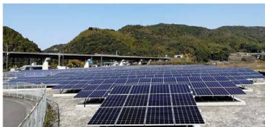
上原太陽光発電所
