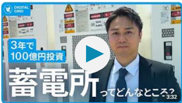
【蓄電所を初公開】いま注目の系統用蓄電池—デジタルグリッドが蓄電所をつくる理由とは—
