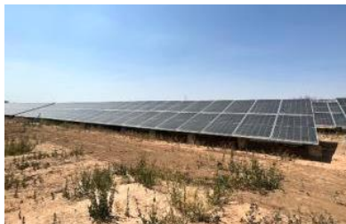
マフラク地区Sabha(ヨルダン) 太陽光発電所
