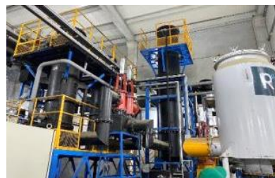
トルコ北西部ボル県、Goynuk(ゴイヌク) のバイオマス・ガス化発電所
