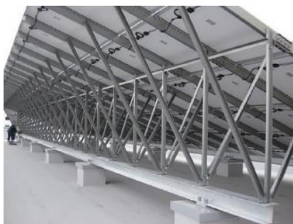
太陽電池アレイ支持架台
