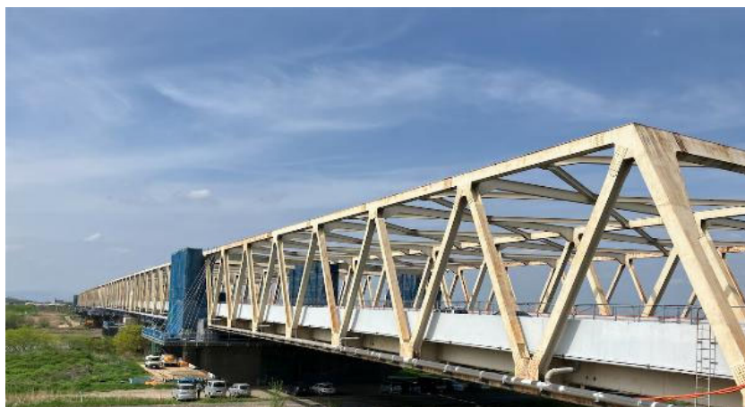
東北自動車道 利根川橋耐震補強工事 東日本高速道路株式会社
