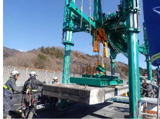
中央自動車道(特定更新等) 中野橋床版取替工事(2023年度) 中日本高速道路株式会社 富士ピー・エス・宮地エンジニアリングJV
