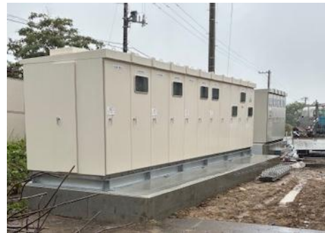
仙台開発センター（キュービクル設置）
