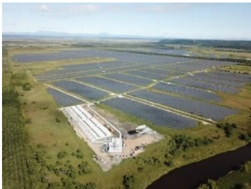
〈すずらん釧路町太陽光発電所〉
