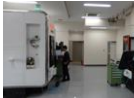
1階 複合加工機・ マシニングセンタを設置
