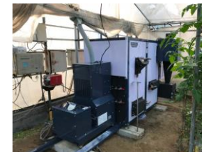
バナナ農園に設置したバイオマスボイラー
