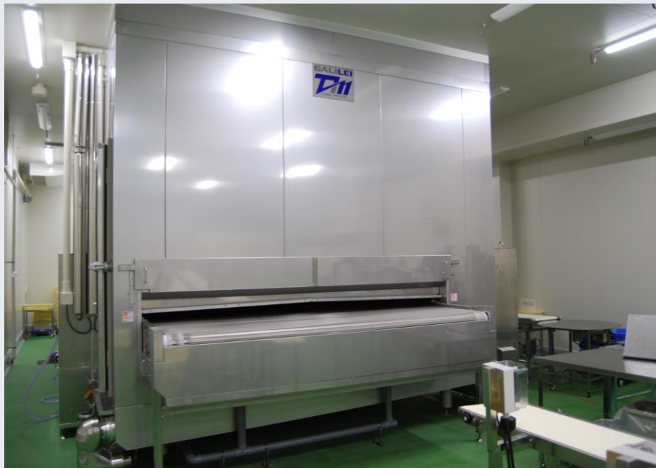
新設された冷凍設備
