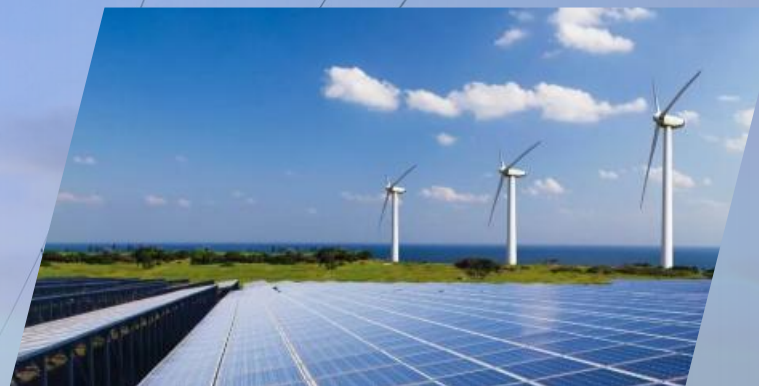
設備事業 (再生可能エネルギー発電所事業)
