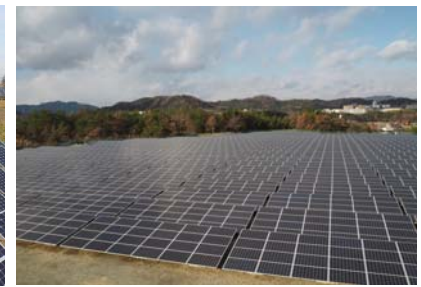
いちご東広島西条町田口ECO発電所
