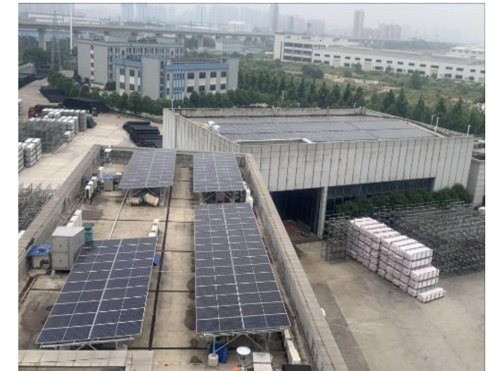
太陽光パネル設置事例
