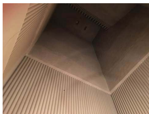
大仙バイオマスエナジーの炉内
