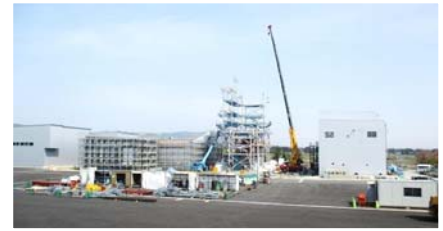
※花巻バイオマスエナジープラント設置工事(H28/4末時点)
