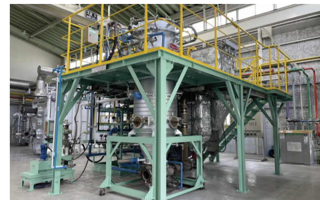
火炎内処理設備の受注も継続
