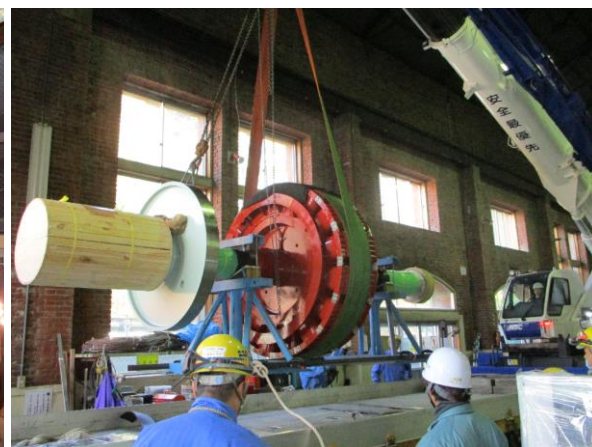
発電機回転子
