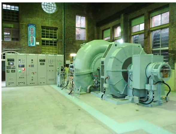
水車発電機制御装置外観
