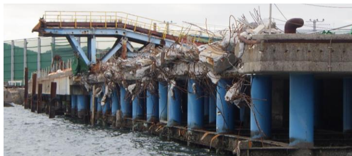
台風で船が漂流、栈橋に衝突・破損した状況
