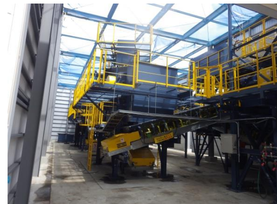
※③ リサイクル設備 (いわき中央アスコン・福島県)
