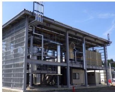
越路原プラント内の実証設備 (NEDO※事業)
