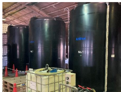
【本社工場尿素水専用大型タンク】
