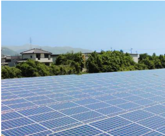
コンパクトソーラー発電所
