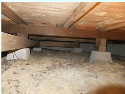
無断熱の床下
