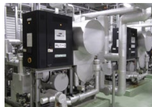
脱フロン化、自然冷媒 機器への更新 (物流、他)
